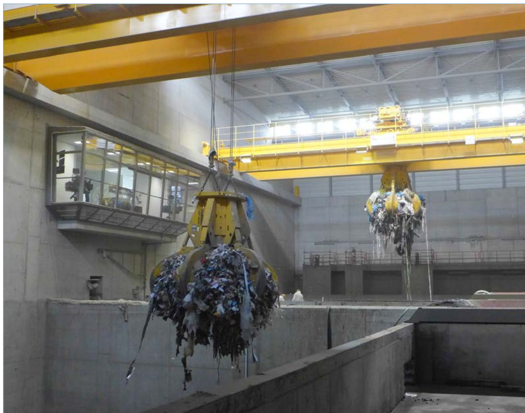
Brennbare Siedlungsabfälle im Bunker der KVA Renergia Zentralschweiz AG. (Bild: uwe)
