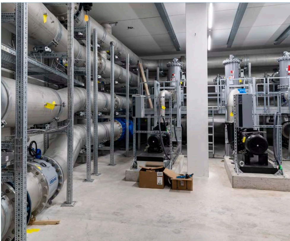
Seewasserzentrale Schützenmatt (Zug) des Projekts CIRCULAGO mit Leitungssystem für die Seewasserzirkulation und den Leitungssystemen für die Energieverteilung. (Bild: zVg)
